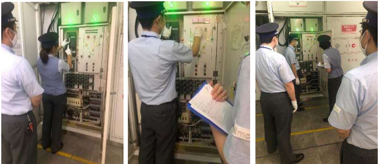
運転指令と打合せて分岐制御装置を操作して進路を構成
